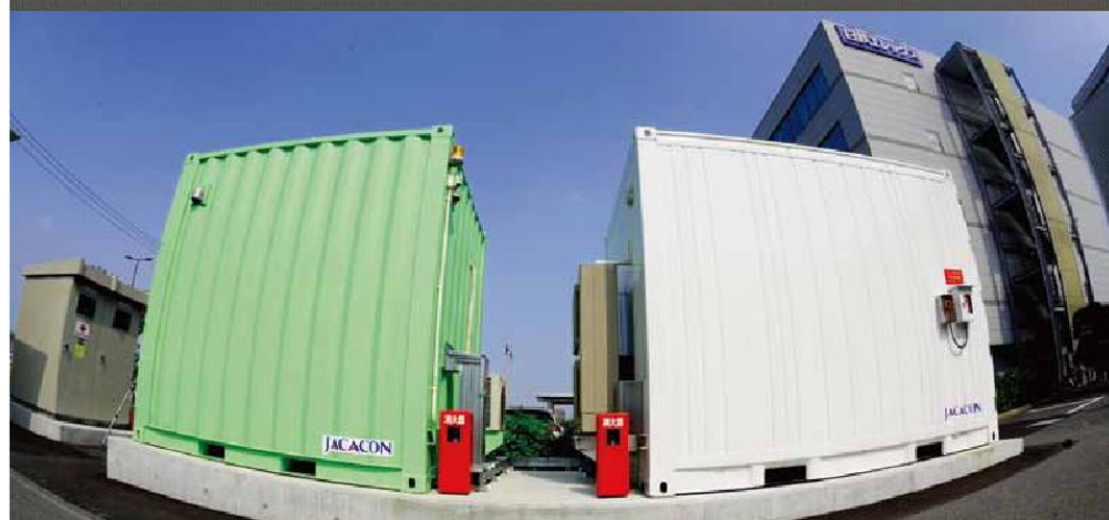
上：日鉄エレクトックスのBEMSによるエネルギー 需給状況 下：左40kw・右50kwの大型蓄電池
