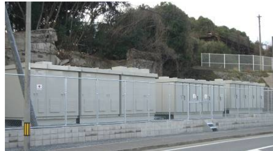
コミュニティ設置型蓄電池 (300kW)
