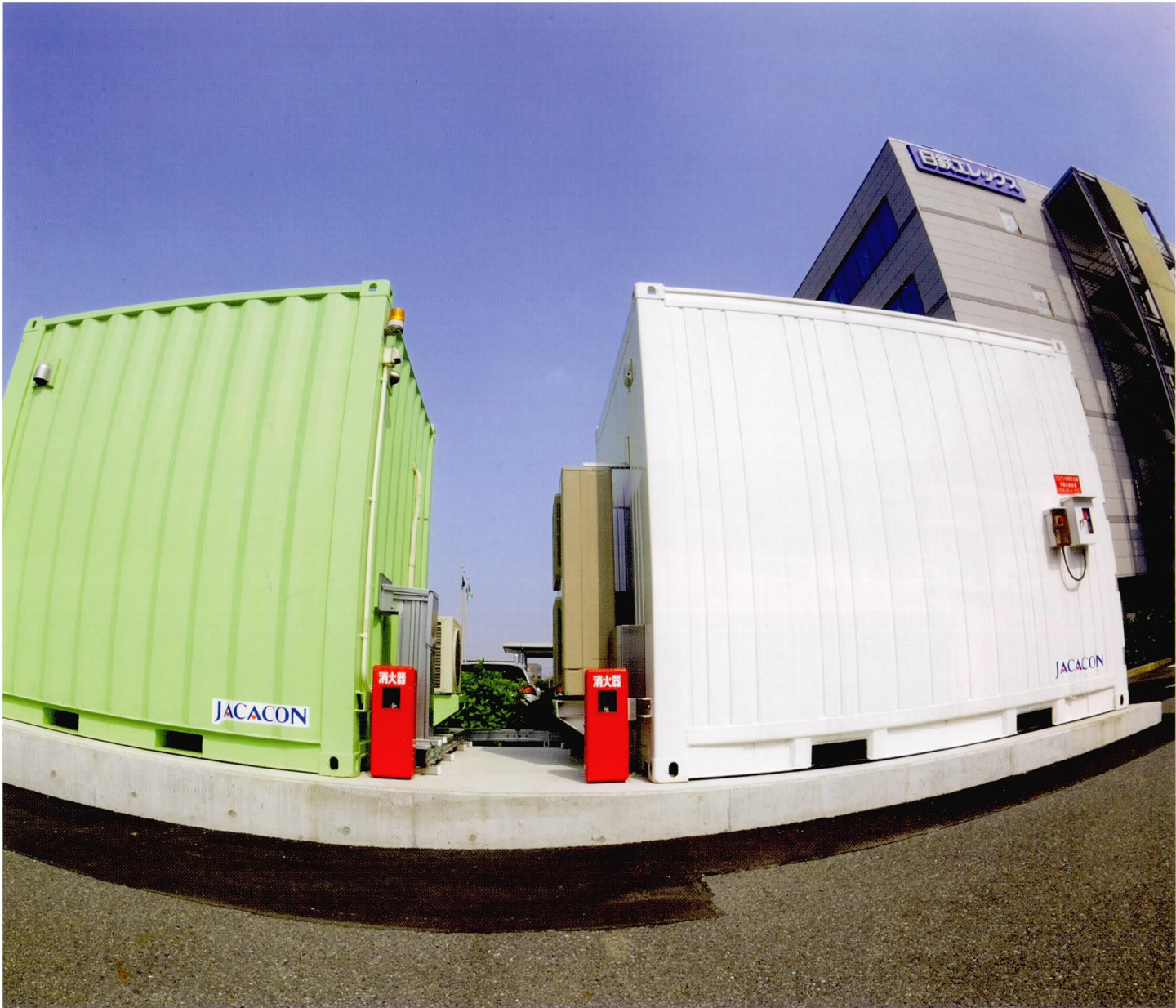
左40kw・右50kw。「日鉄住金テックスエンジニア」の大型蓄電池
