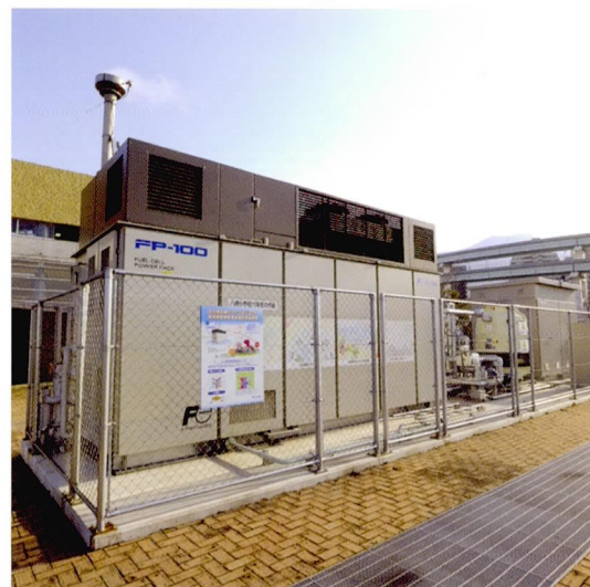
100kWの水素燃料電池
