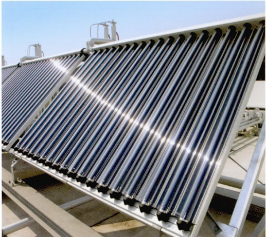
太陽熱利用パネル
