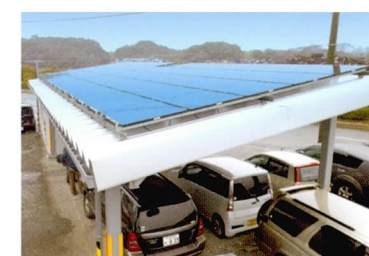
駐車場屋根の太陽光発電システム（10kW）
