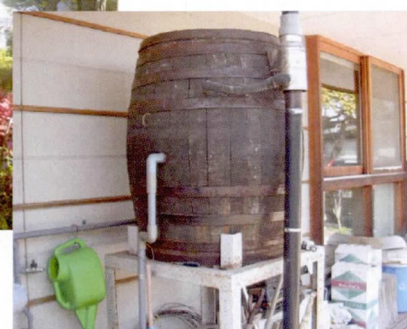
雨水タンクの整備
